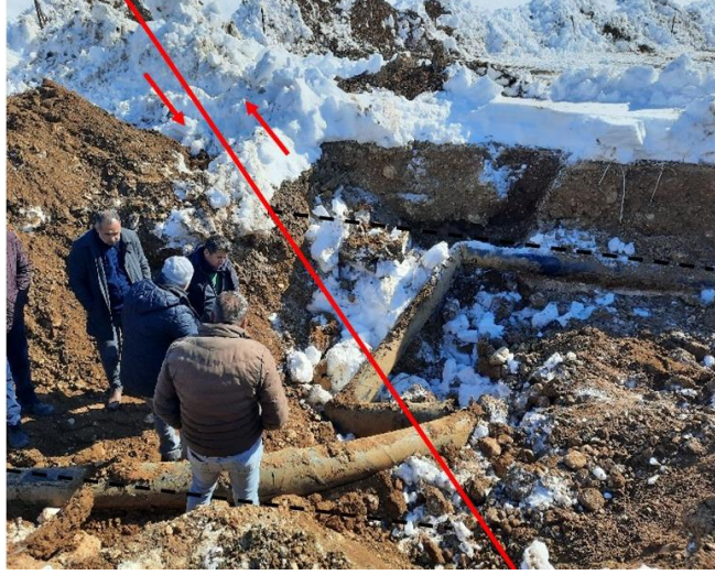
Şekil 5. Çelikhán-Adıyaman yolu üzerinde su borusunda gözlenen 3 metre sol yanal ötelenme.
