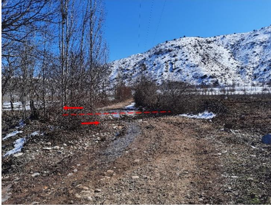
Şekil 12. Aksu Göleti kuzeyinde doğalgaz hattında deformasyon.
